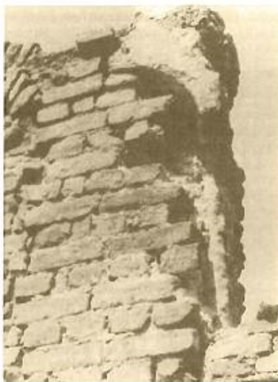
3. Elfalazott déli hajóablak a helyreállítás megkezdése előtt
